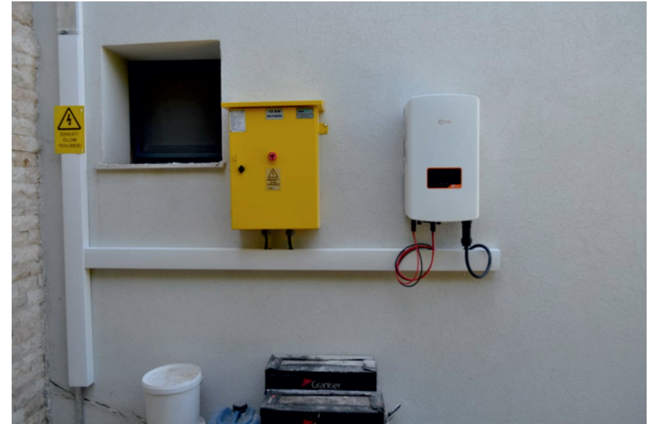
Mikro GES Panosu ve İnvörtör
