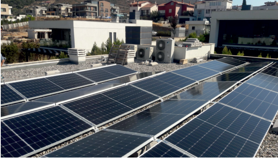
KASAPOĞLU VİLLA GES 15 kWp, 2022, Güzelbahçe / İZMİR
